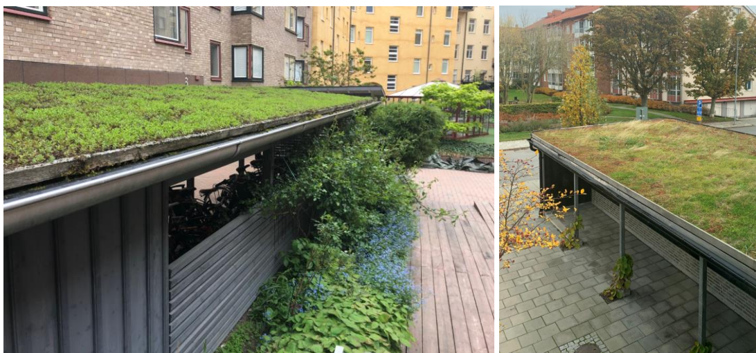
Figur 20. Exempelbilder på skärmtak med växtlighet. Vid tillfällen då växtligheten och jorden är mättad samlas vatten upp i hängränna. Foton tagna av Bjerking AB.
